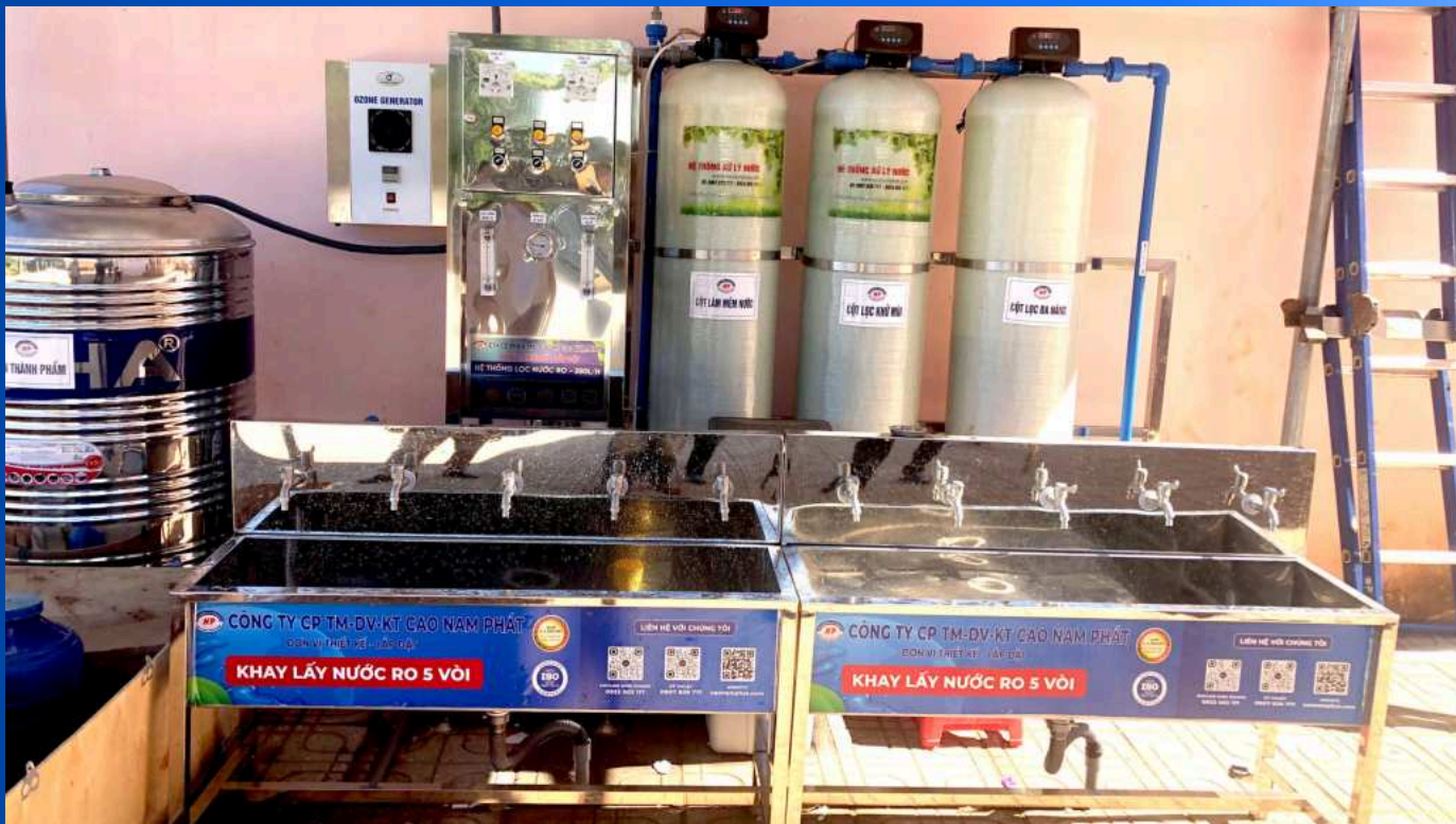
HỆ THỐNG RO LỌC NƯỚC UỐNG TINH CHO TRƯỜNG HỌC
