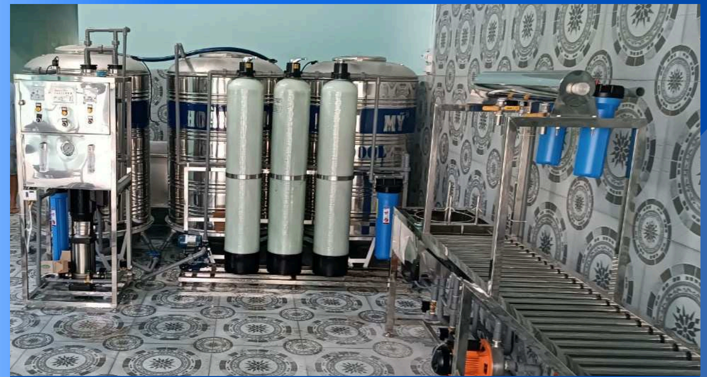
HỆ THỐNG RO-DI SẢN XUẤT NƯỚC UỐNG ĐÓNG CHAI
